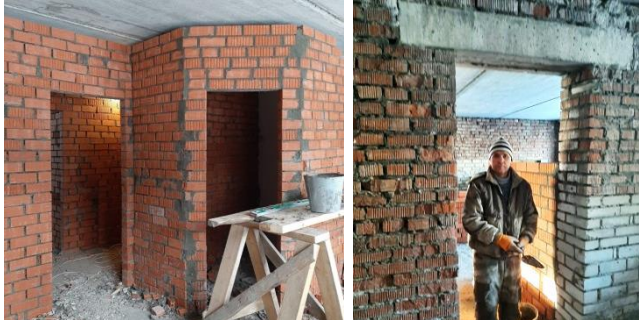
Der Innenausbau des dritten Hauses in Jajwa, der von der Diözese Augsburg gefördert wird, nimmt Gestalt an.
